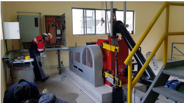
Foto 1.- Vista de la Turbina Pelton con sistema de deflectores y de regulación por transferencia de carga.
